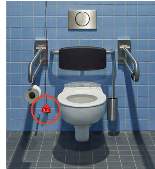
Notrufanlage in Toilettenräumen, Sportpark Freiam, München
